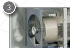
Turbina de refrigeración
