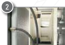
Turbina de refrigeración
