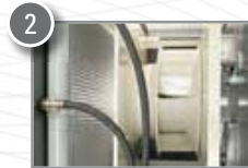
Turbina de refrigeración
